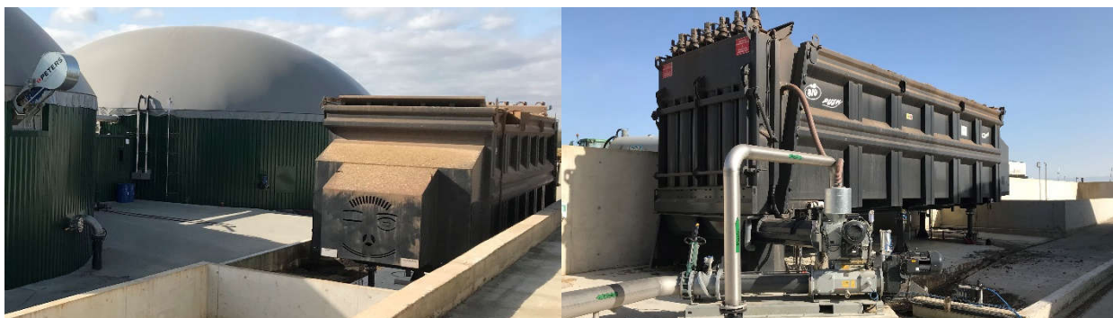
Trémie d'incorporation et pompe mélangeuse (CA02)
