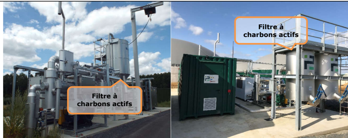
Photo : Filtres à charbon actif présents sur des sites de méthanisation (CA02).
