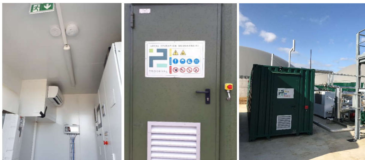
Photos : Vues sur les détecteurs de fumées et la grille de ventilation du container du module d'épuration d'un site de méthanisation (CA02).
