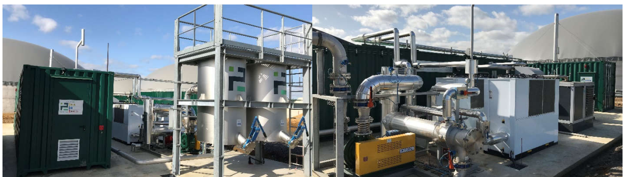
Unité d'épuration (CA02)
