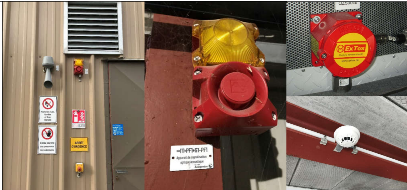
Photos : Alarmes sonores et visuelles, détecteurs de fumées et de gaz sur une unité de méthanisation similaire à BIOCROPS (CA02).
