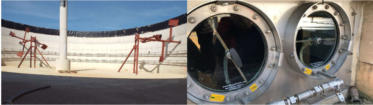
Digesteur avec isolation et gazomètre, réseau de chauffage interne, agitateurs lents à pâles, hublots de contrôle (CA02)
